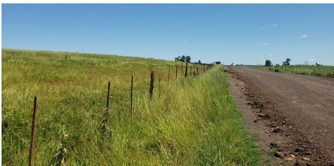
Figura 2 – Margem da estrada com asfalto recém implantado com desgaste devido ao escoamento apenas superficial da água de chuva.
