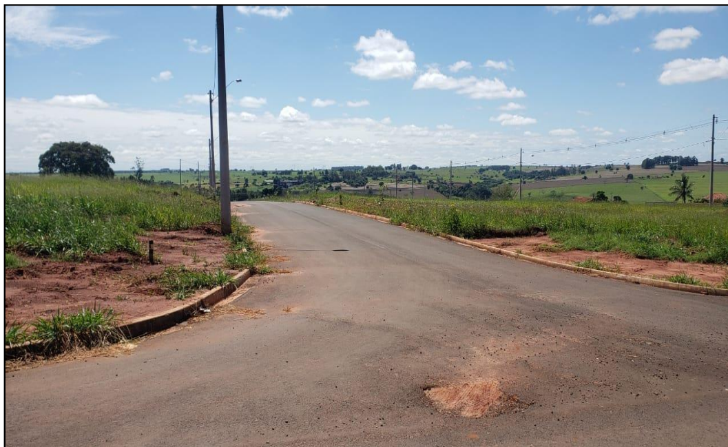
Figura 3 – Asfalto recém instalado com buracos e desgaste devido a insuficiência do sistema de drenagem na área de expansão urbana.
